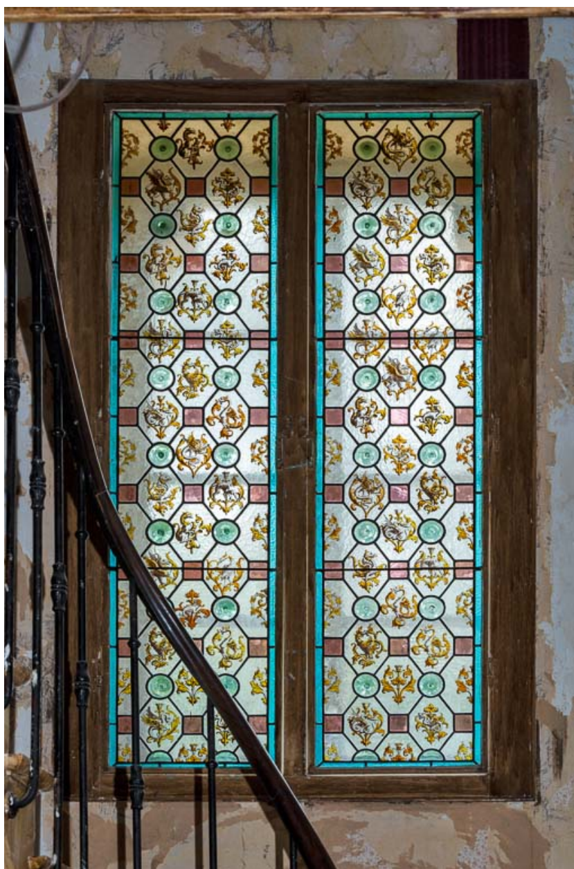
Vue d'ensemble des deux châssis.
