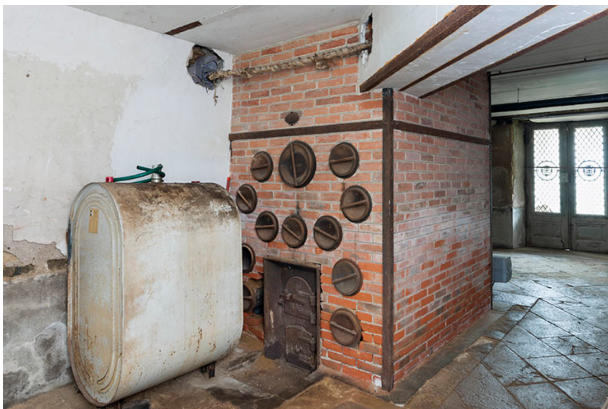
L'ancien chauffage centrale du château.
