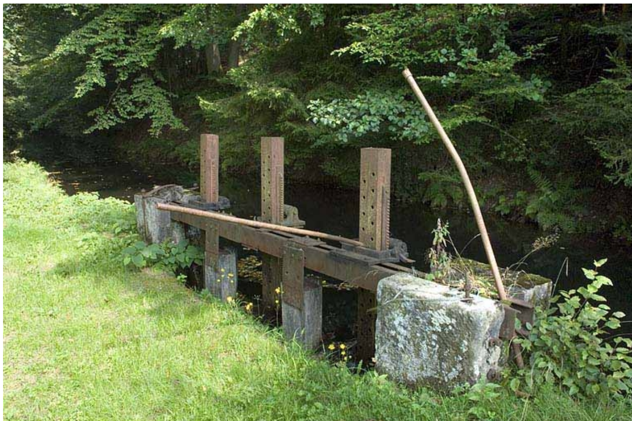
Vanne de décharge sur le bief d'amenée.
