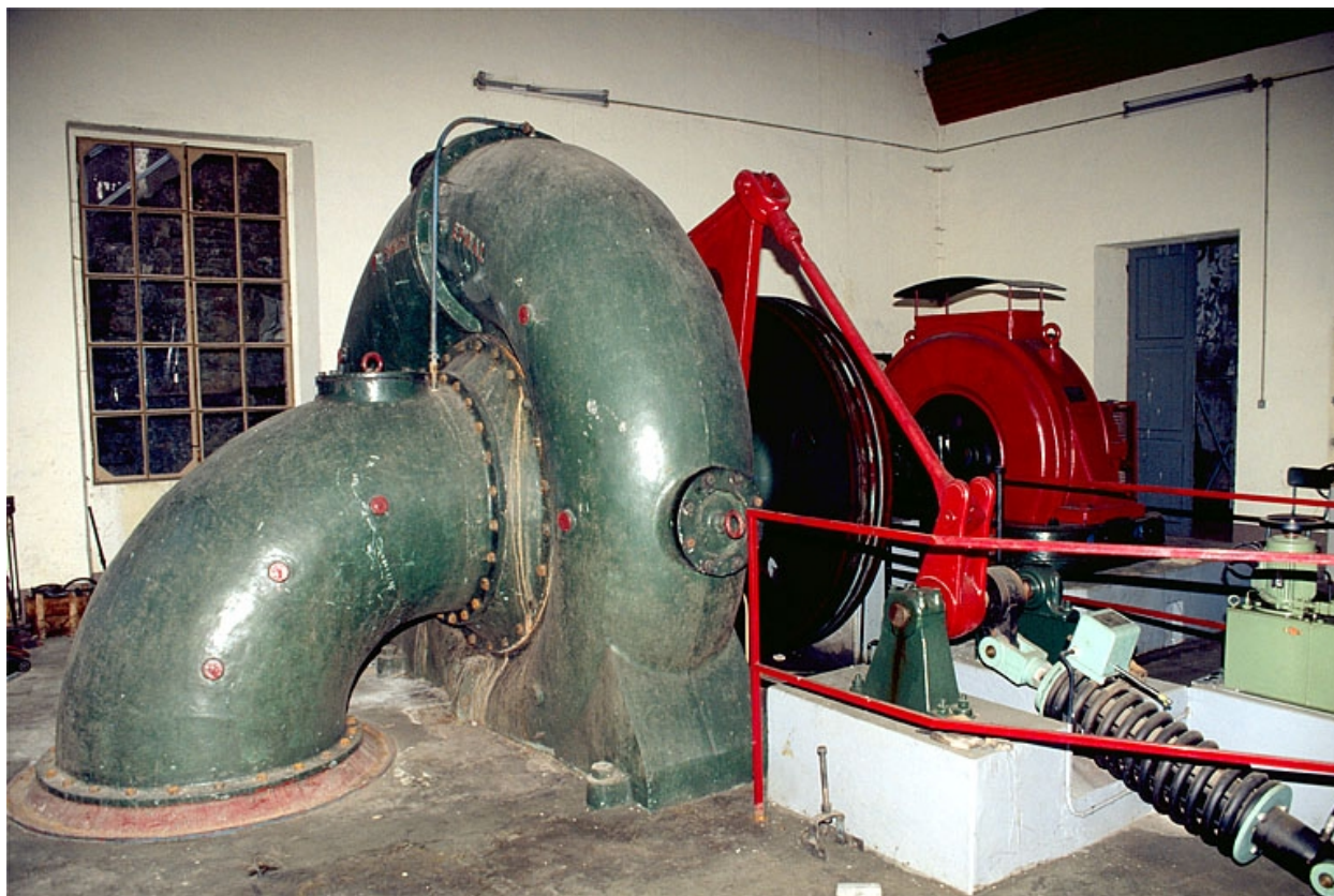
Vue rapprochée de la turbine n° 3.
