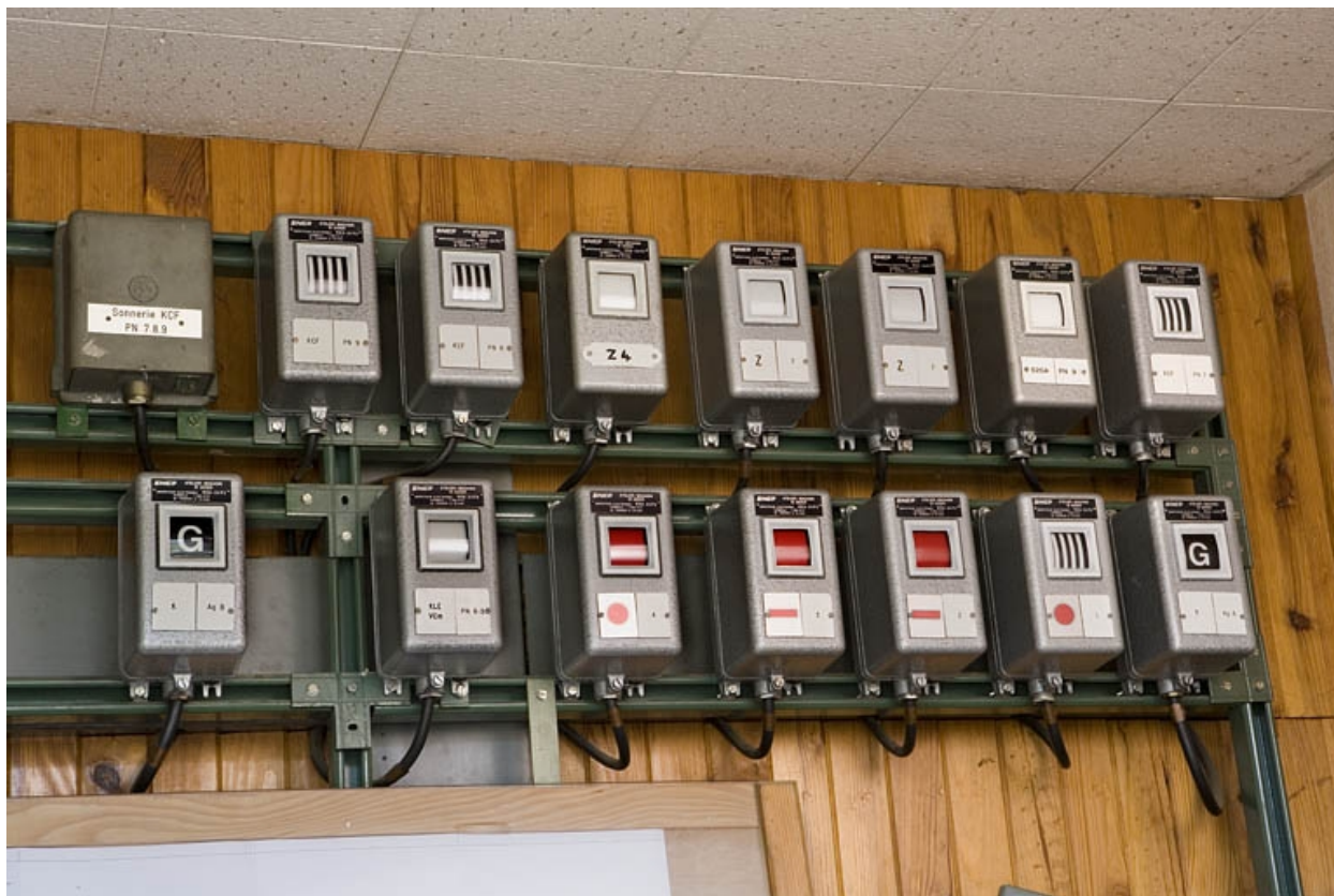
Galleries de répéteurs optiques et sonnerie.
