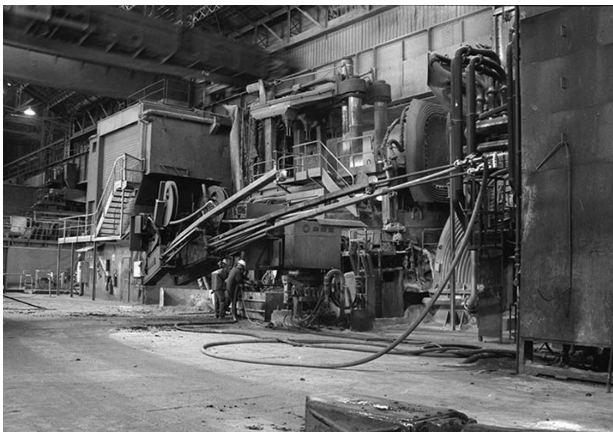
Le four électrique de 100 tonnes en activité.
