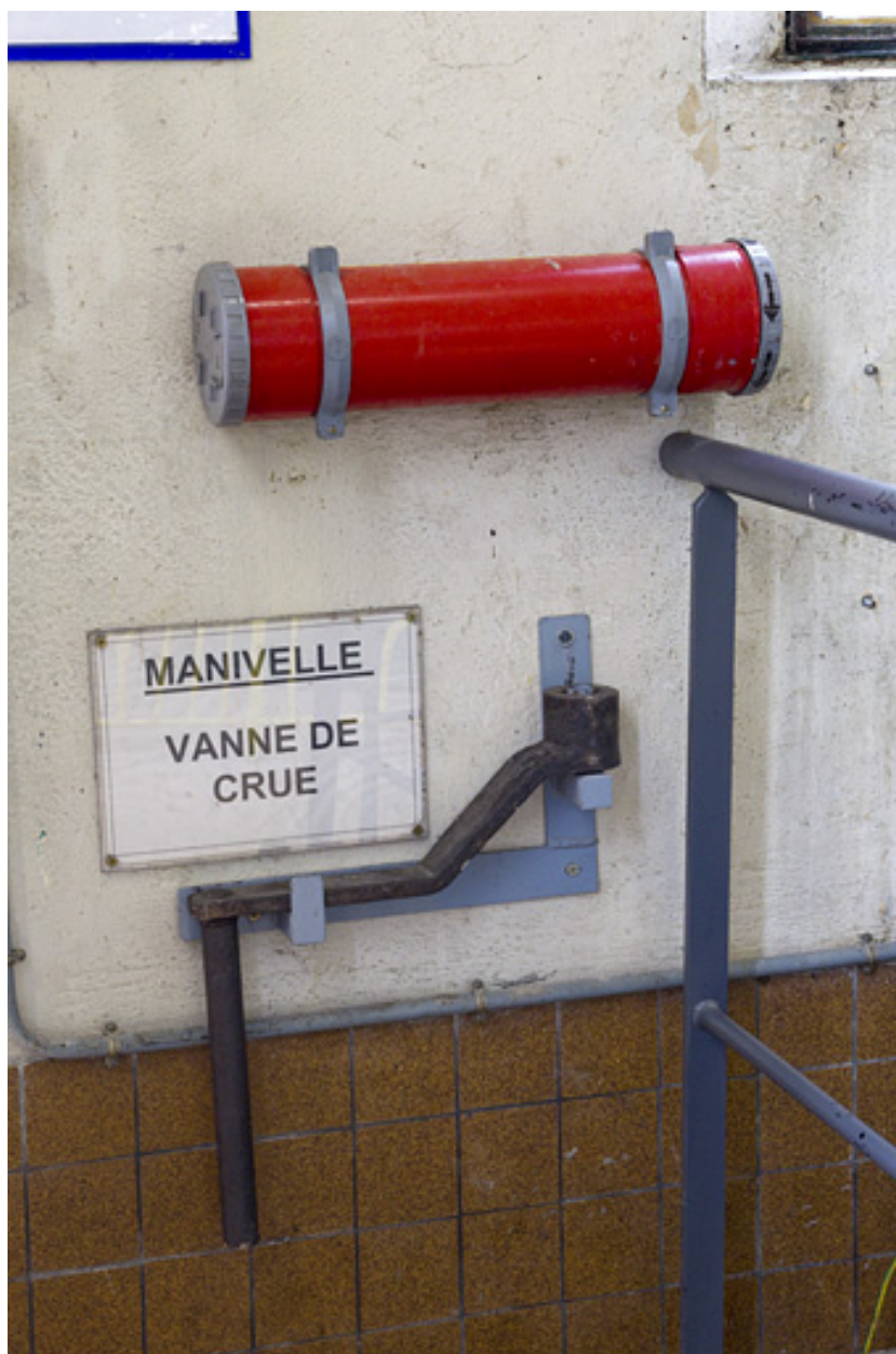
Manivelle de secours (commande du vannage).
