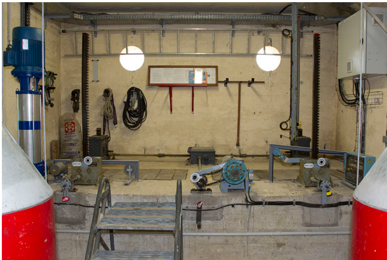
Barrage : commande des vannes de garde.
