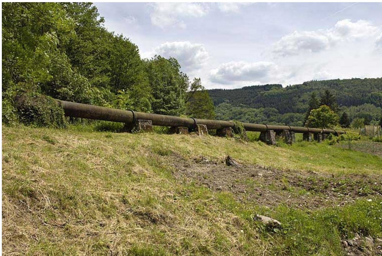
Conduite forcée de la centrale hydroélectrique.
