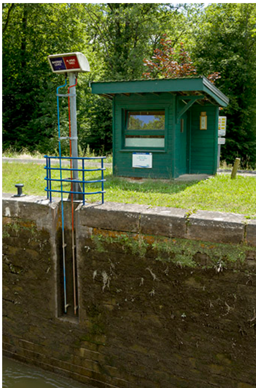
Le poste de commande.
