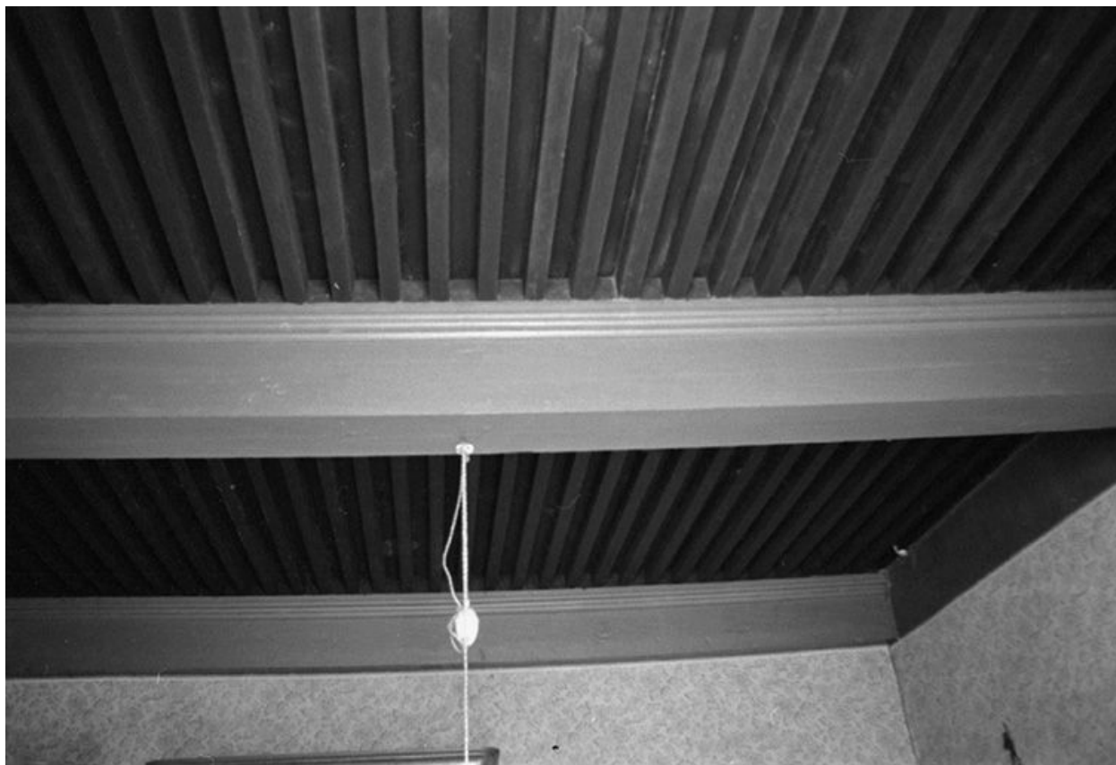
Intérieur : plafond de la cuisine.
