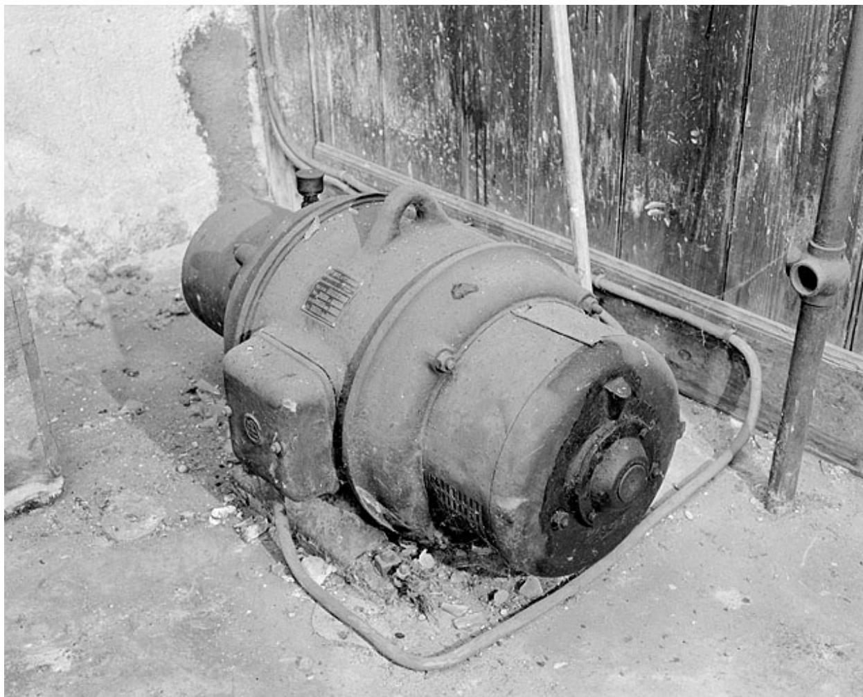
Atelier de mécanique. Moteur électrique.
