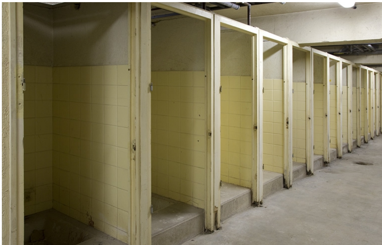
Bâtiment de l'hôtellerie (sous-sol) : bloc sanitaire désaffecté.
