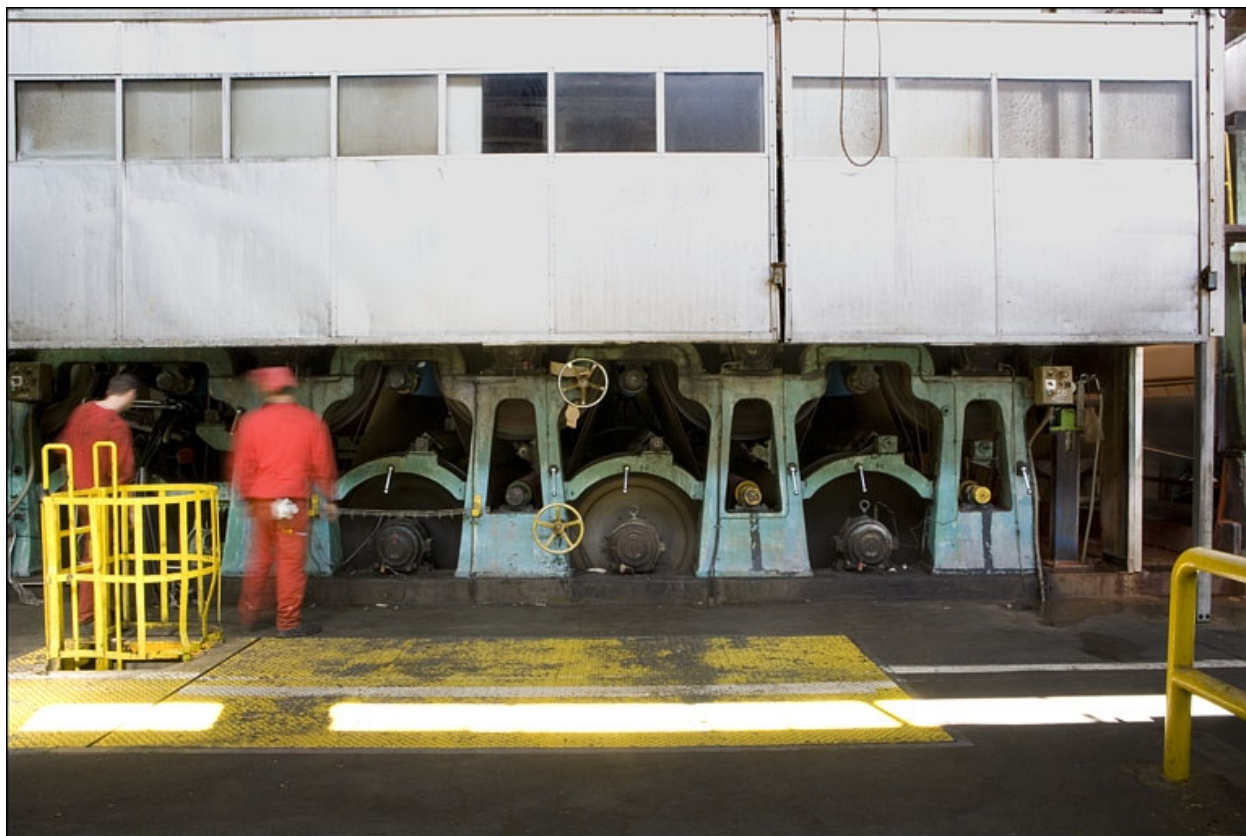
Machine à papier. Vue de face de la sécherie et de ses cylindres.
