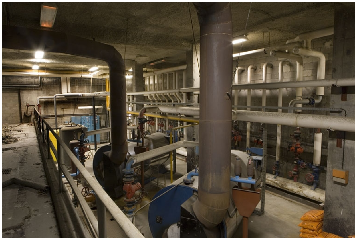
Bâtiment D. Sous-sol. Vue de la chaufferie.
