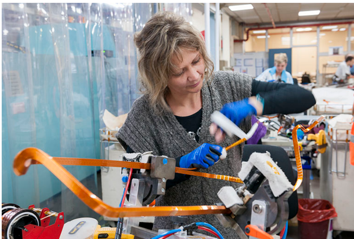
Isolation manuelle des barres de cuivre.
