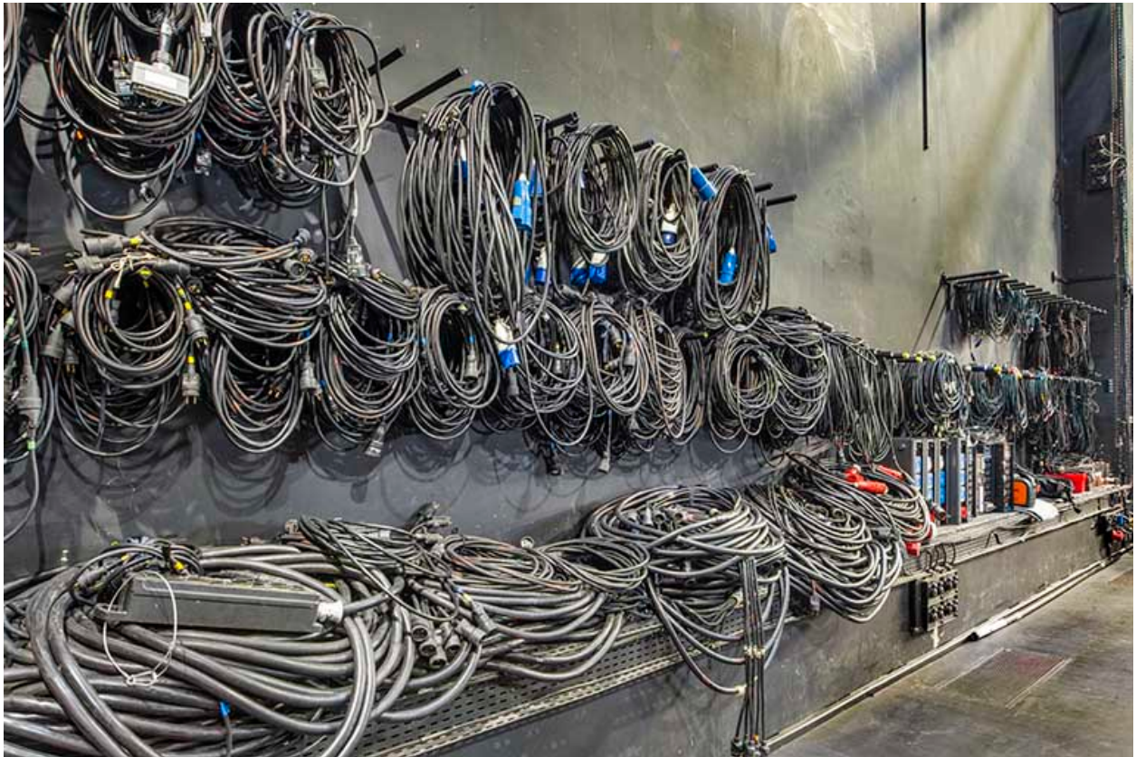
Salle, mur du fond de scène, câbles.
