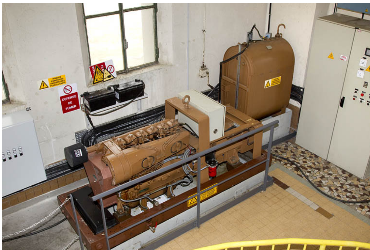
Groupe électrogène de secours (commande du vannage).
