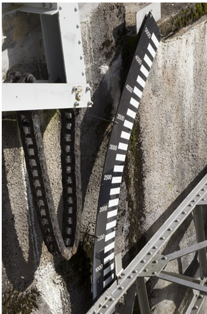
Barrage : repère mesurant l'ouverture d'une vanne secteur.
