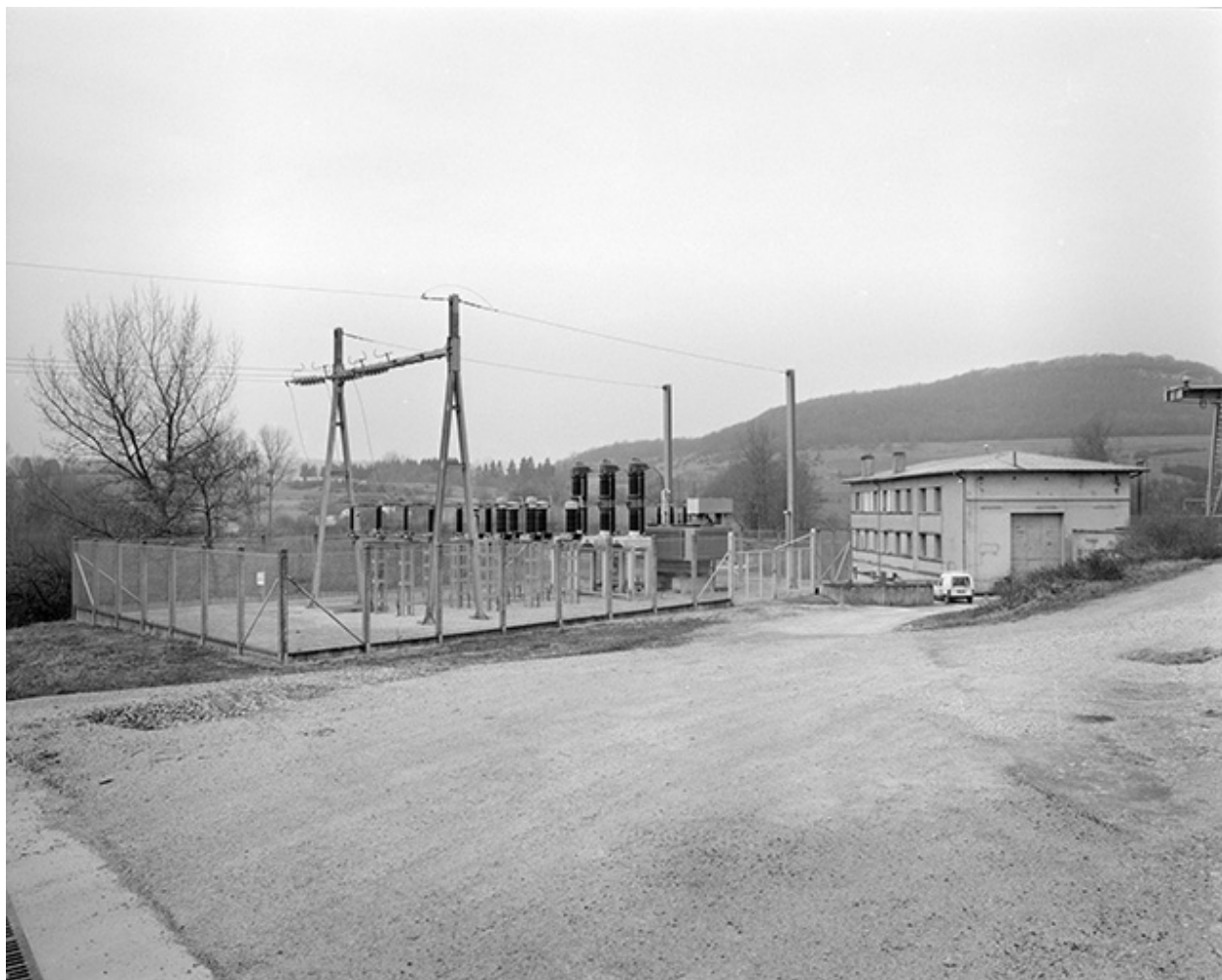
Transformateur et salle des machines.
