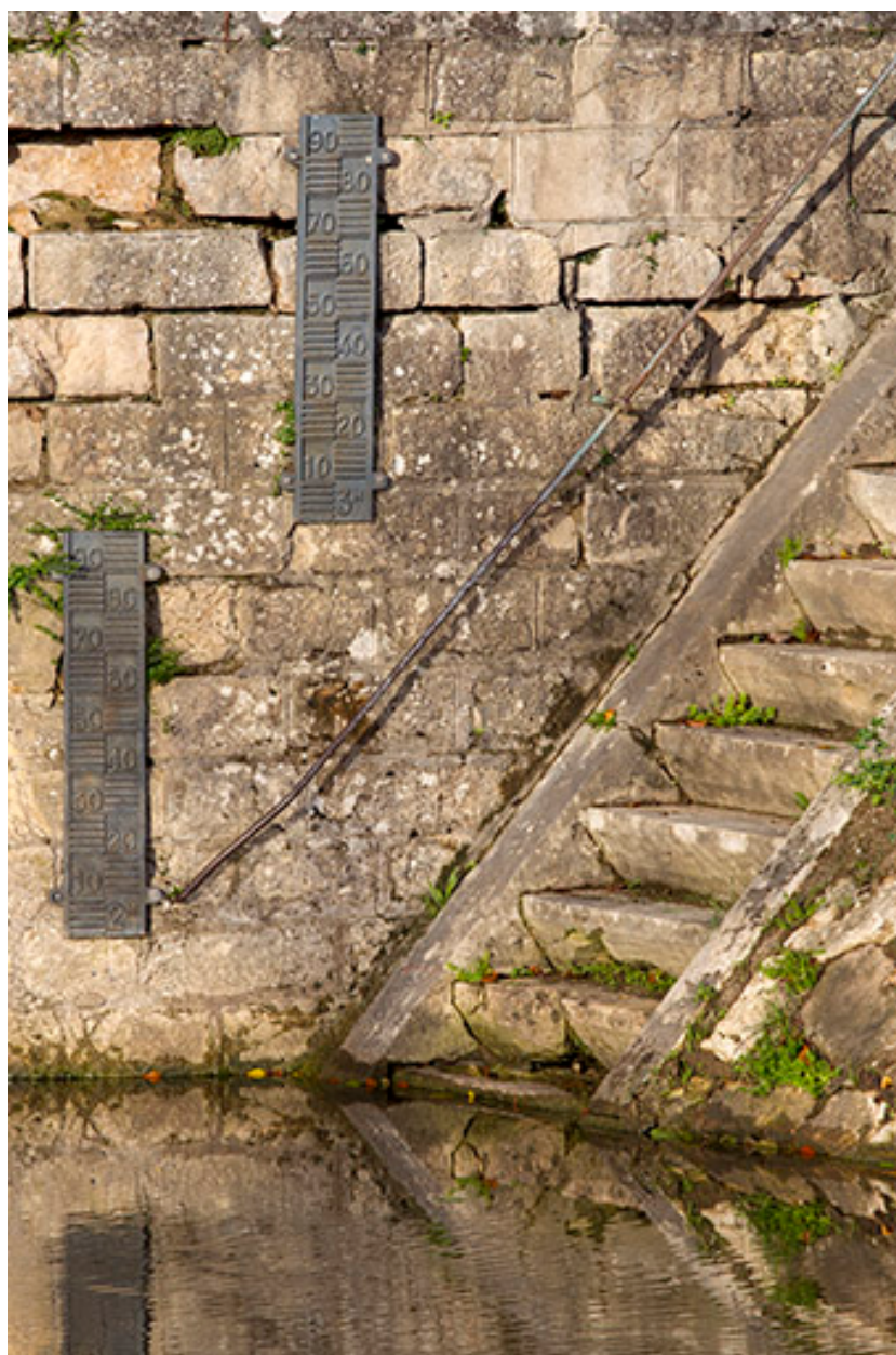
Echelles limnimétriques , porte de garde.
