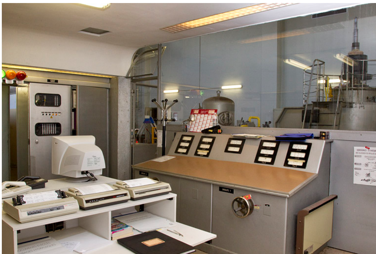
Poste de commande.
