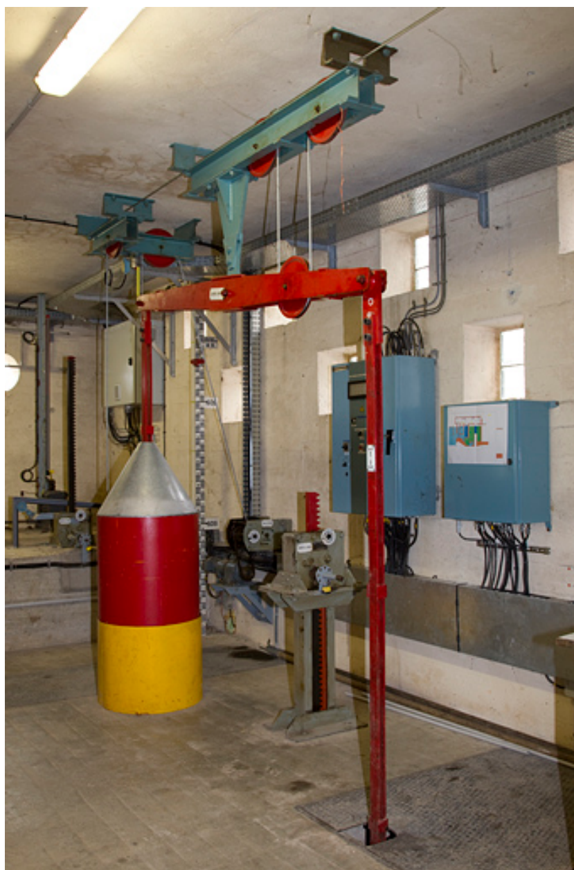
Barrage : soupape d'une vanne toit.
