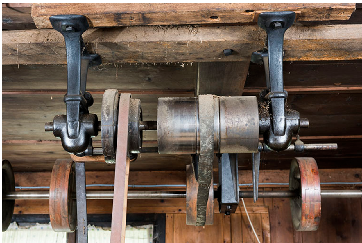
Système de transmission au plafond.
