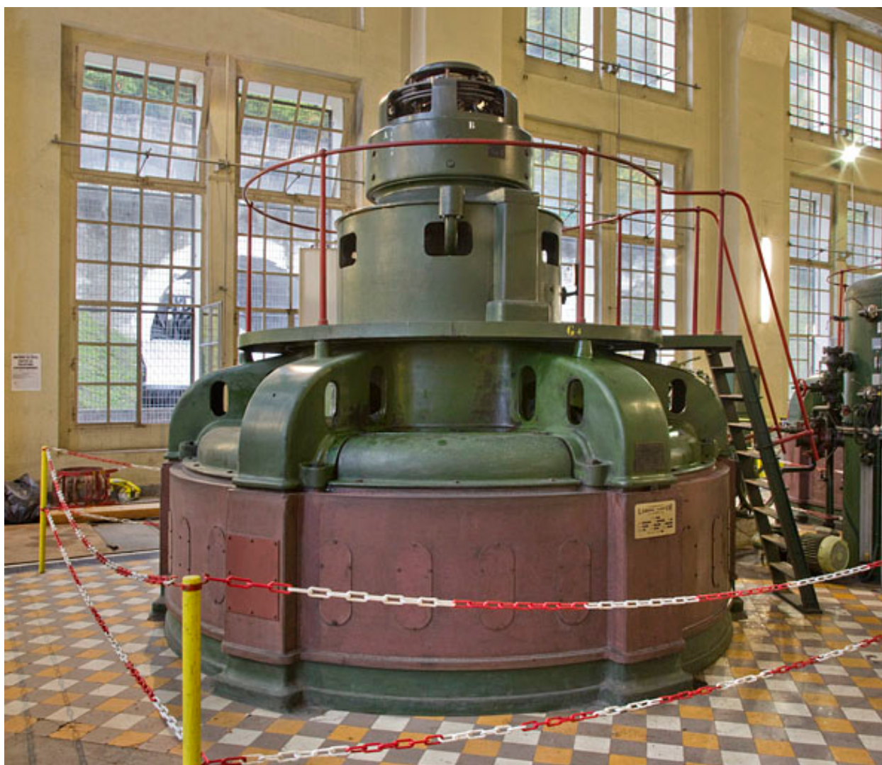
Centrale de Liebvillers : alternateur du groupe n° 4.
