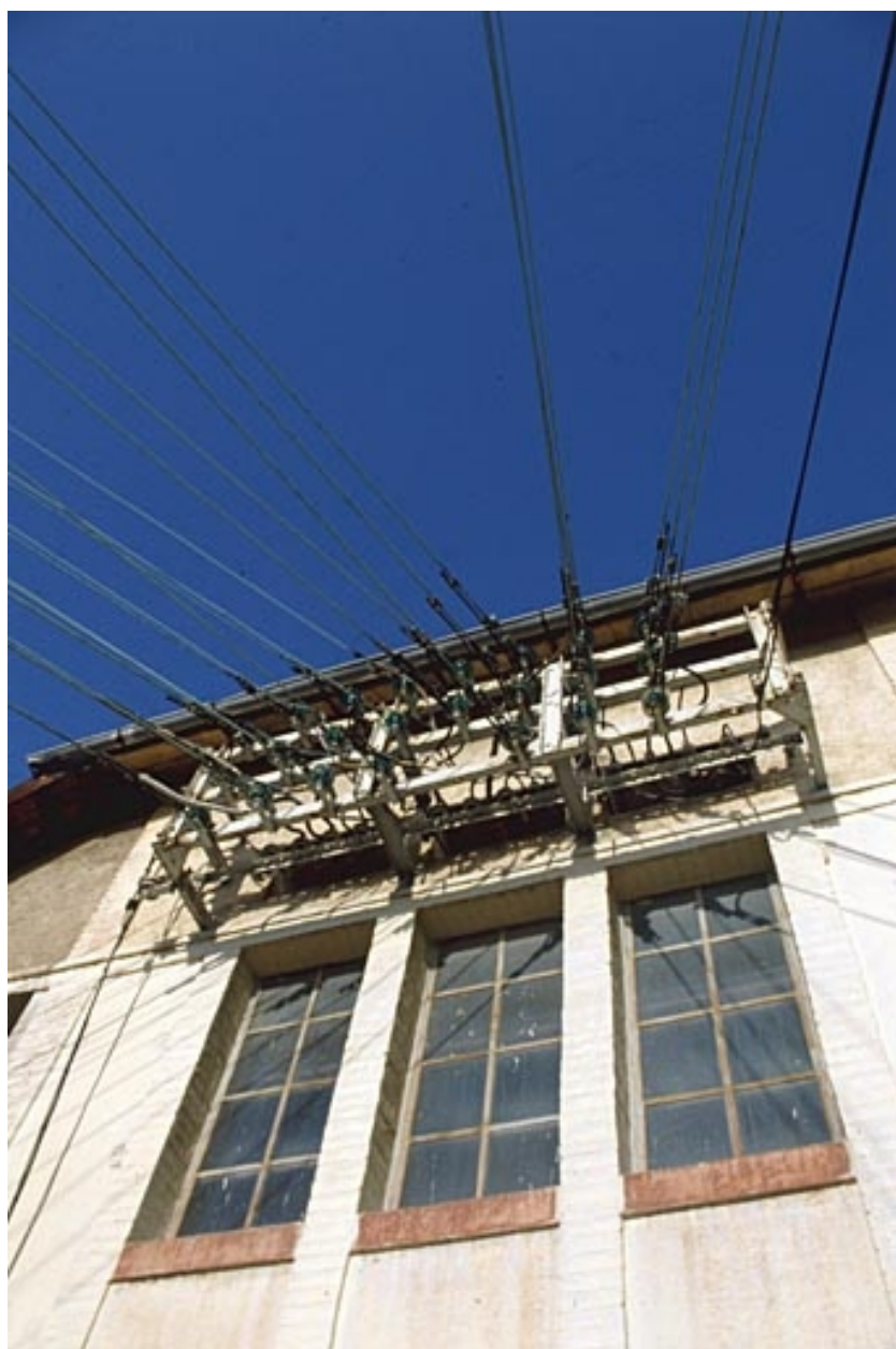
Détail du transformateur : départ de fils électriques.
