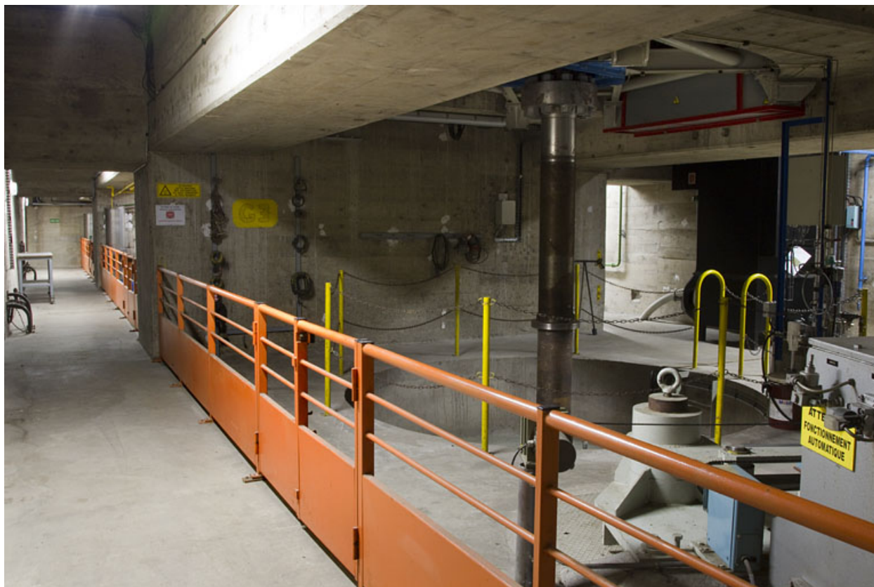
Etage inférieur de la salle des machines.
