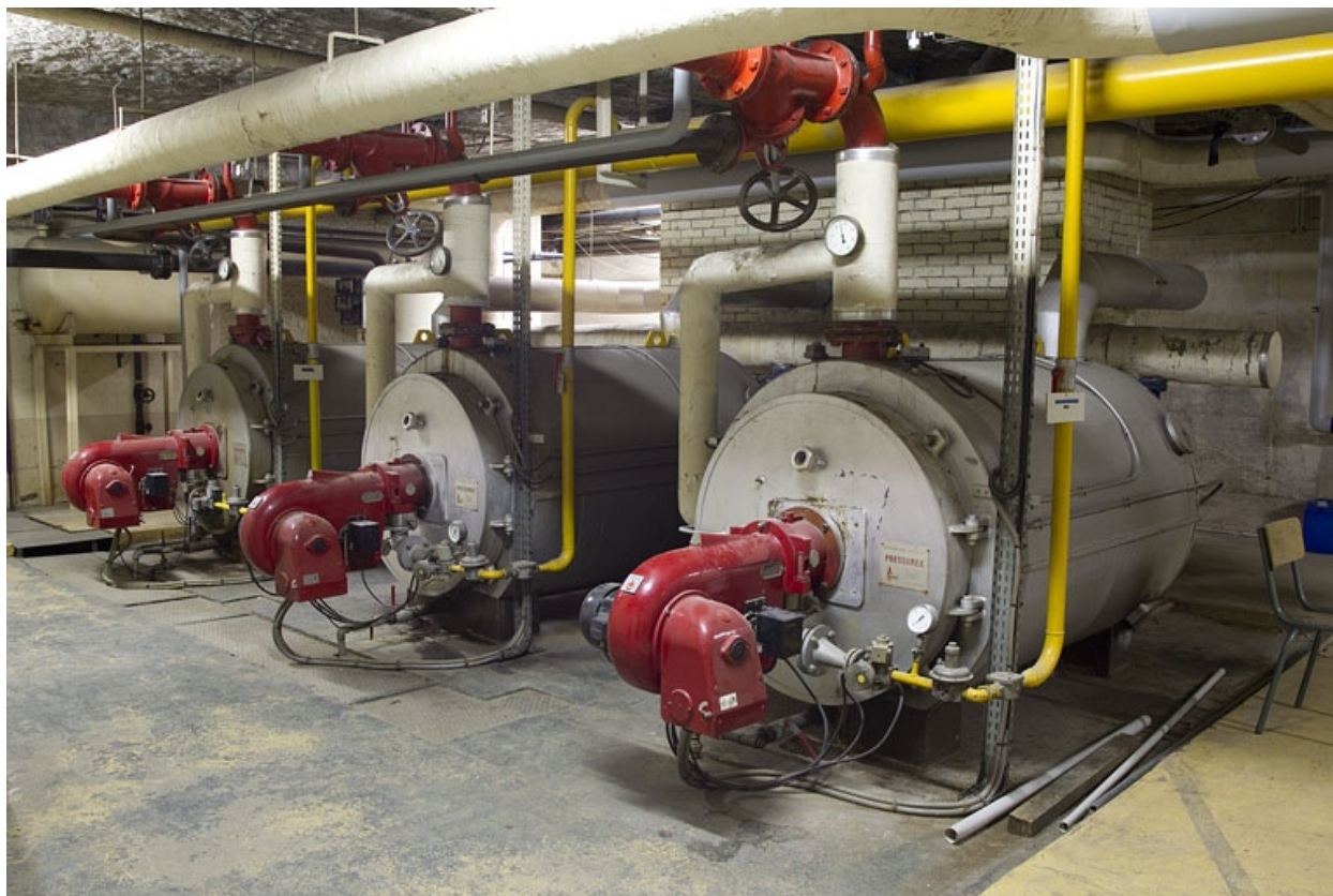
Externat (sous-sol), chaufferie : les chaudières.
