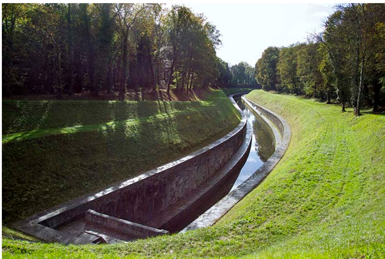
Le canal de navigation en aval.
