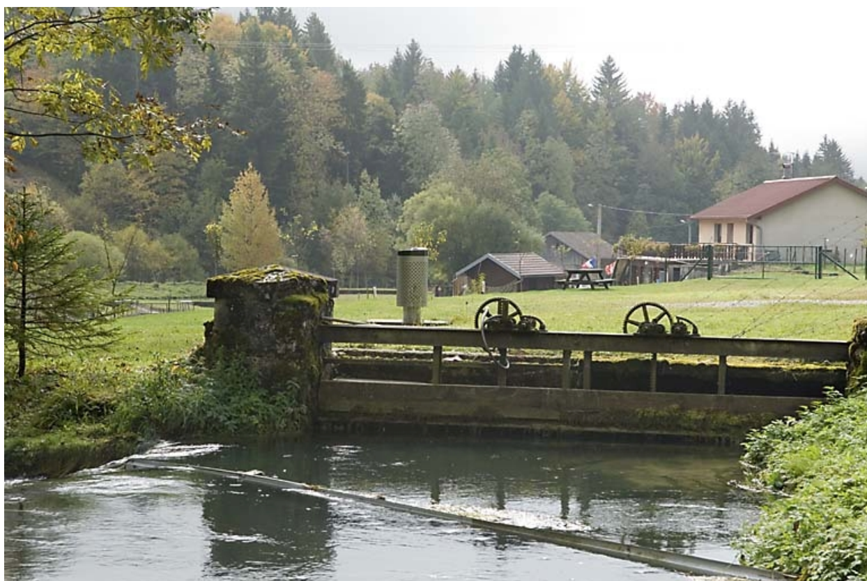
Vannage de prise d'eau.
