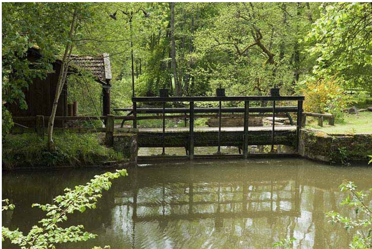
Vannes de décharge sur le bief d'amenée.
