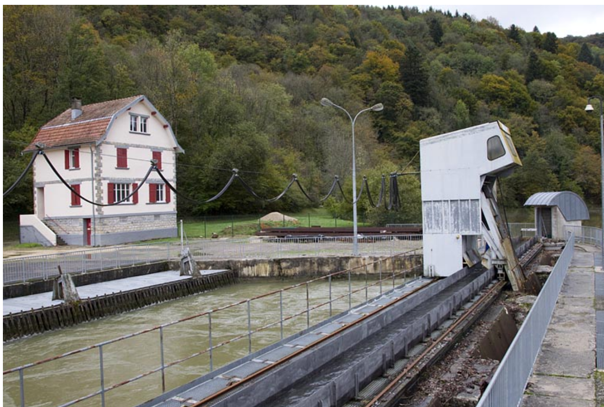
Prise d'eau : vue d'ensemble du dégrilleur.
