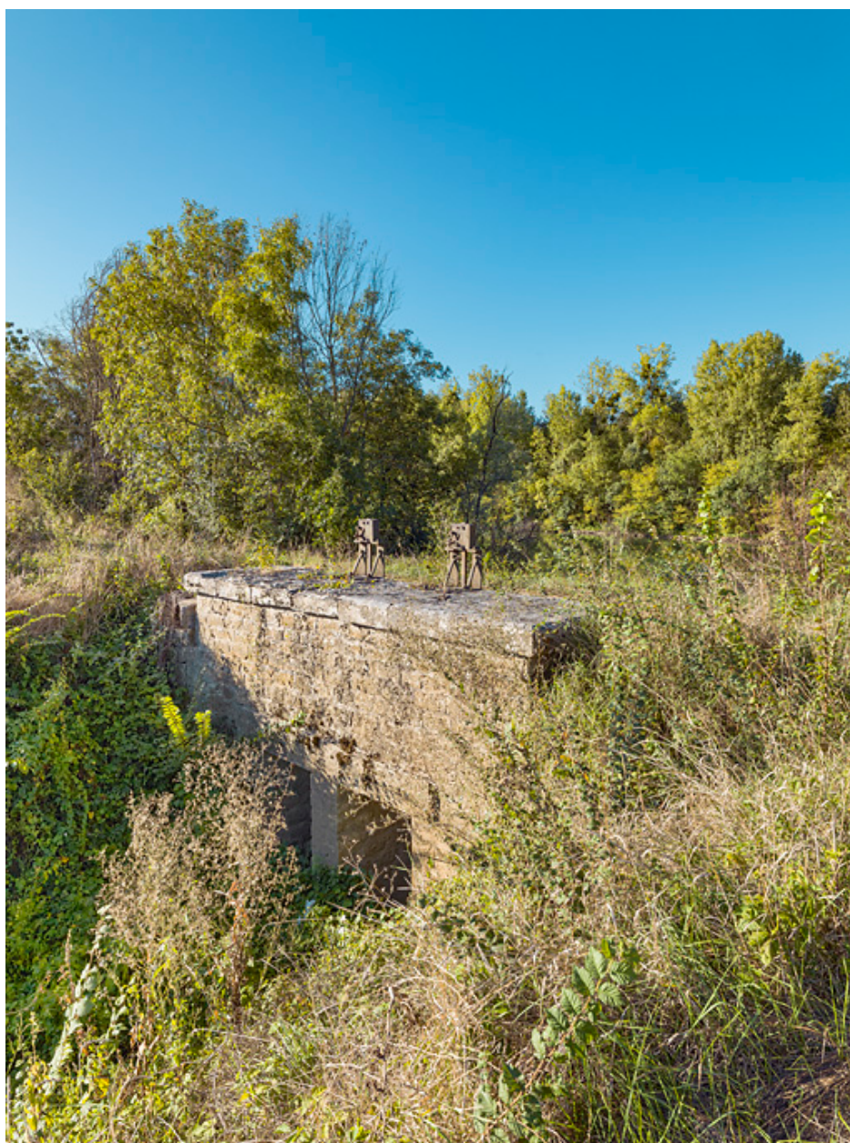
Le système de vannes.
