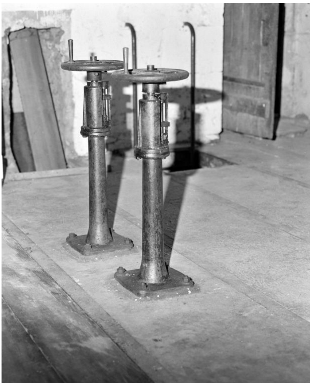
Rez-de-chaussée. Commandes d'ouverture des vannes.
