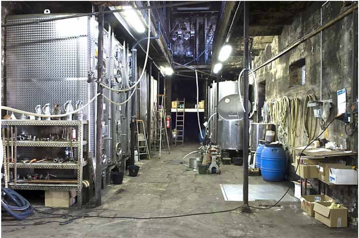
Cuverie. Installations récentes.
