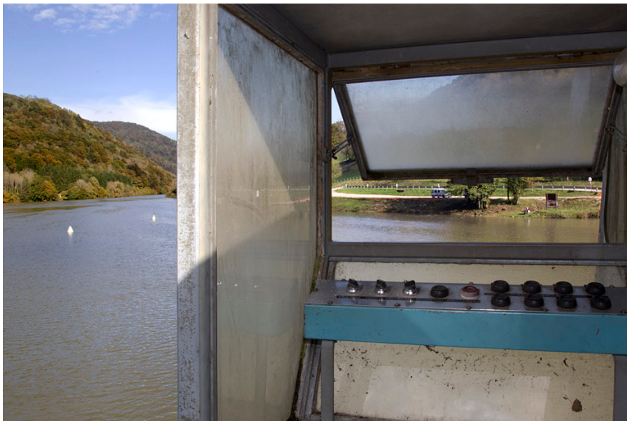
Prise d'eau : poste de commande du dégrilleur.
