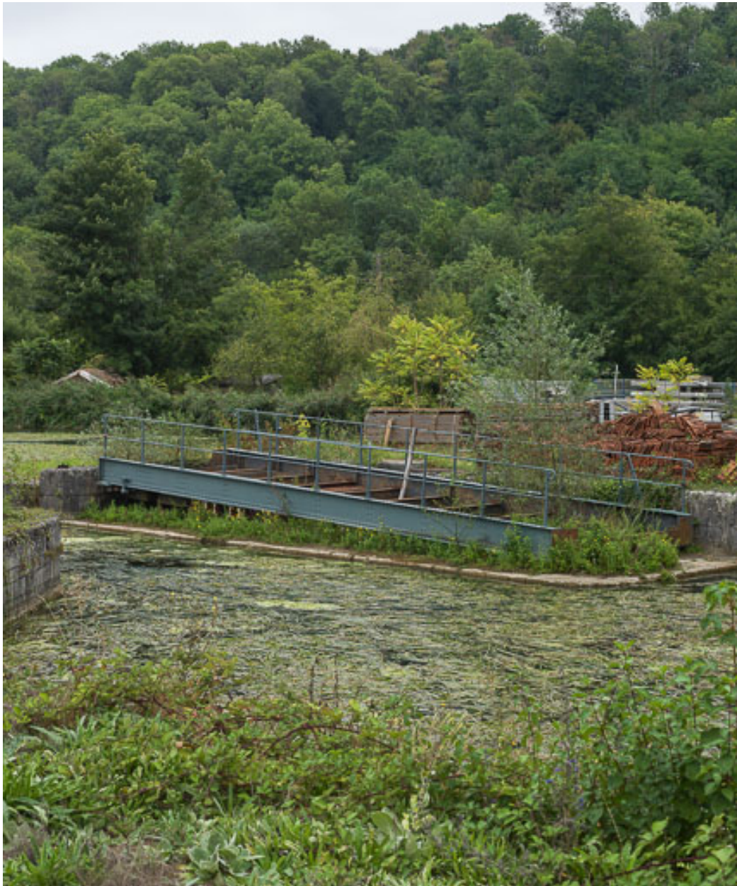
Vue du pont, à l'abandon.
