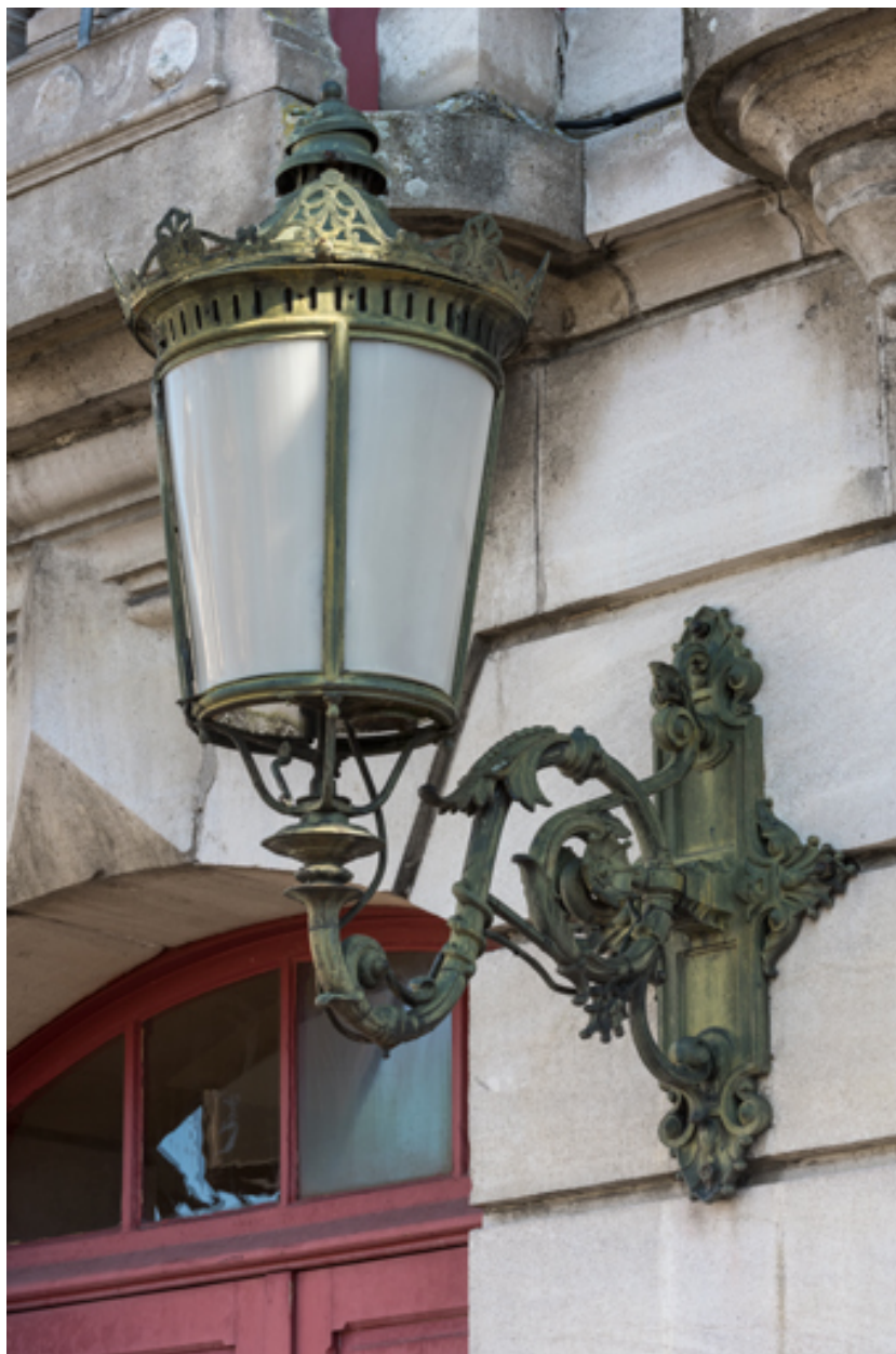
Luminaire d'applique en façade.
