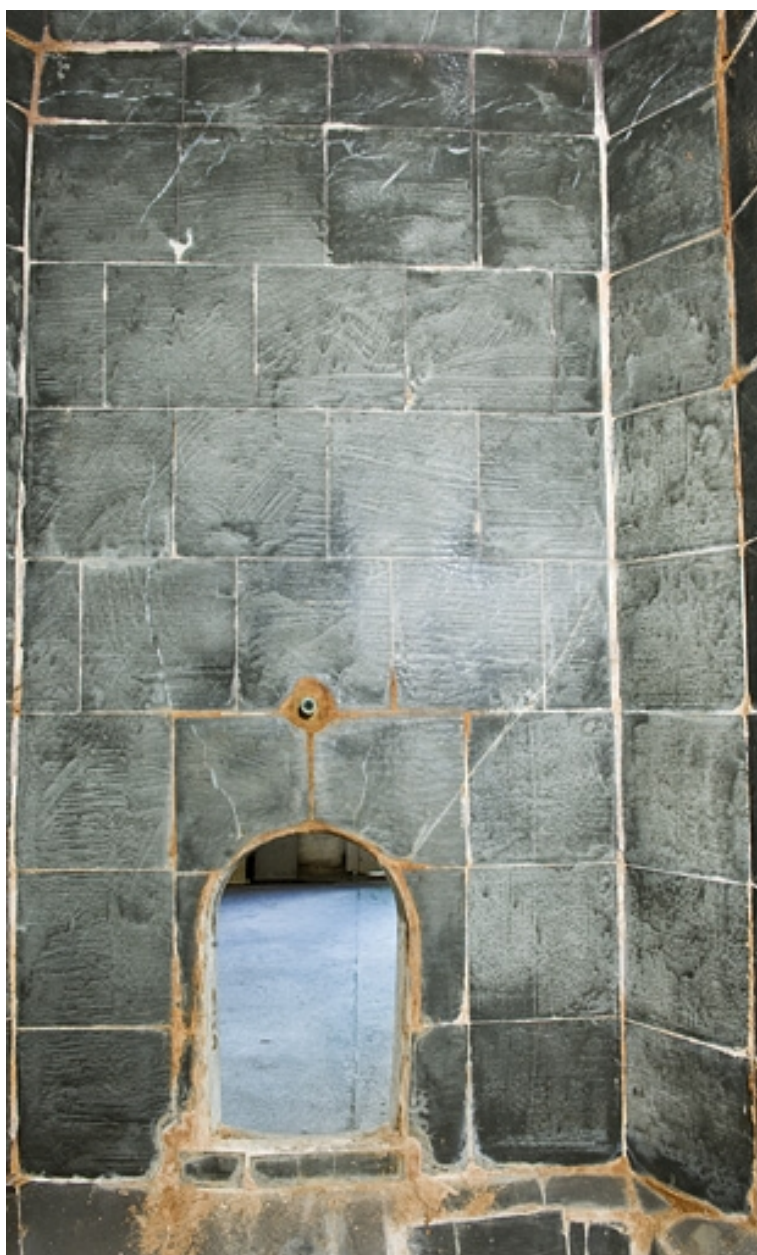
L'ouverture d'une cuve depuis l'intérieur.
