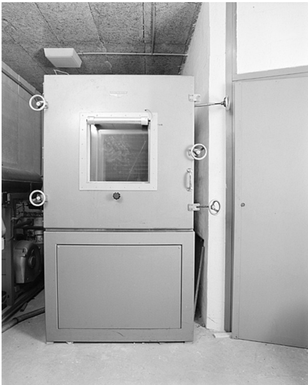
Enceinte d'essais : vue d'ensemble.
