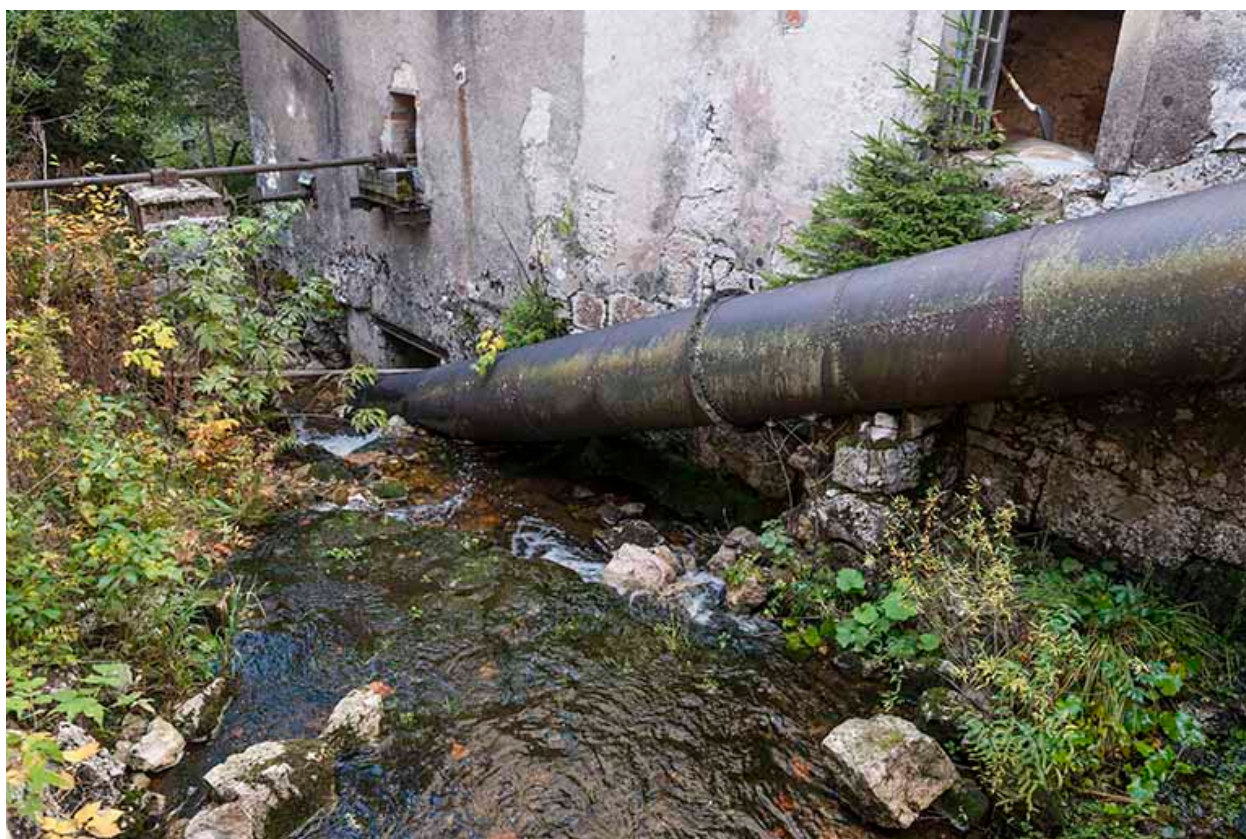
Conduite forcée de la turbine.
