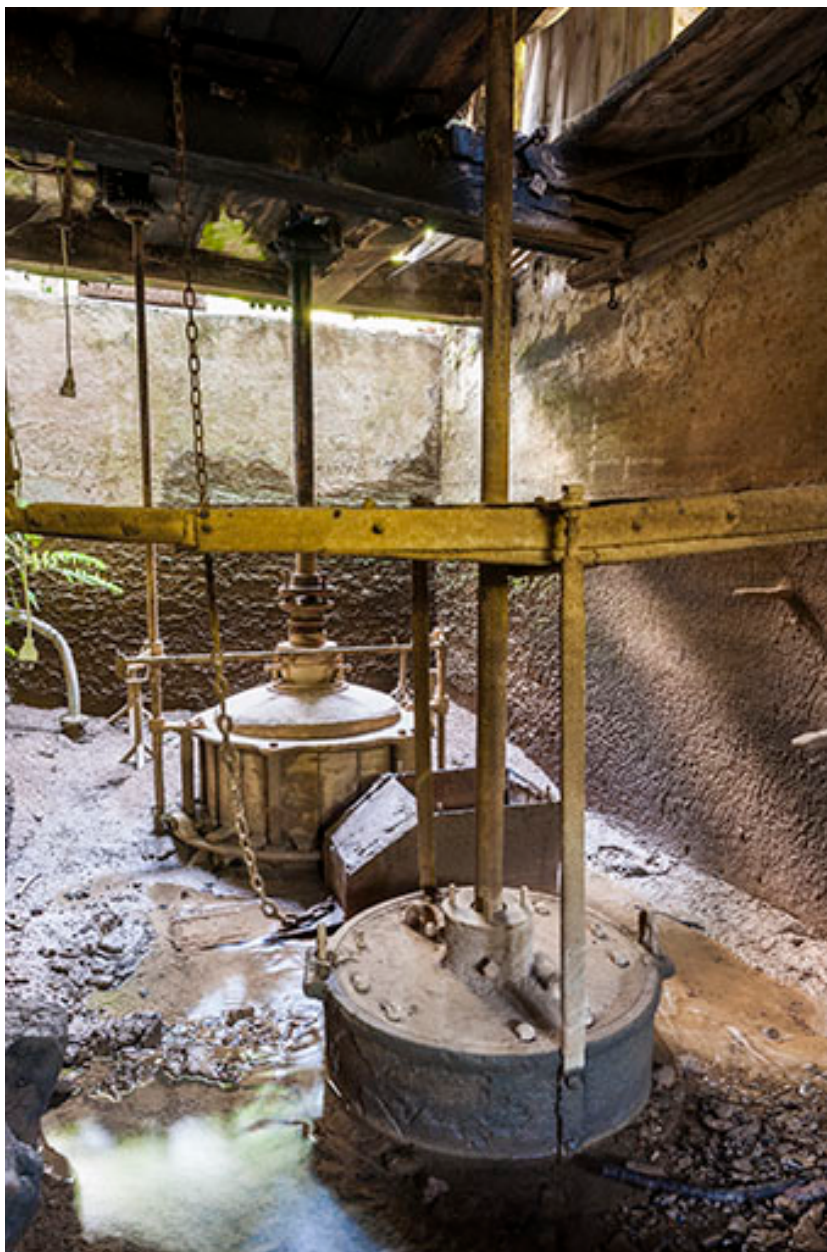
La chambre d'eau des turbines.
