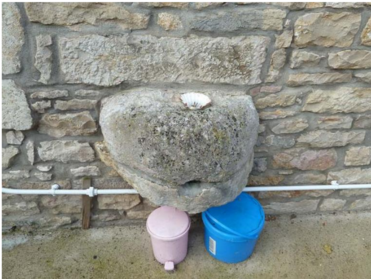
"Goulotte" d'évacuation de l'évier intérieur
