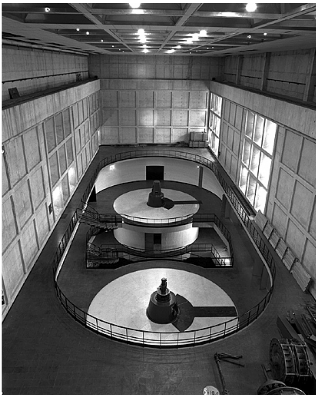
Centrale hydroélectrique du Saut-Mortier, Cernon : intérieur.
