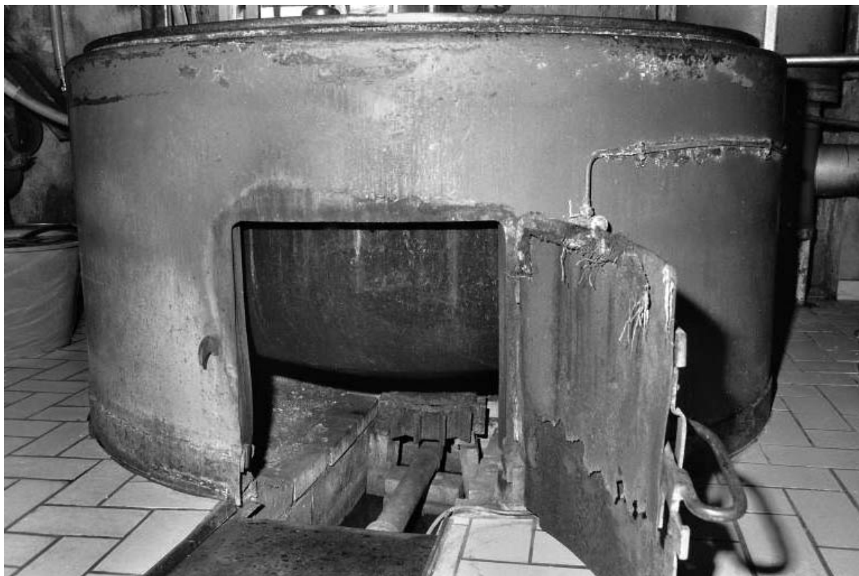
Cuve : brûleur au gaz.
