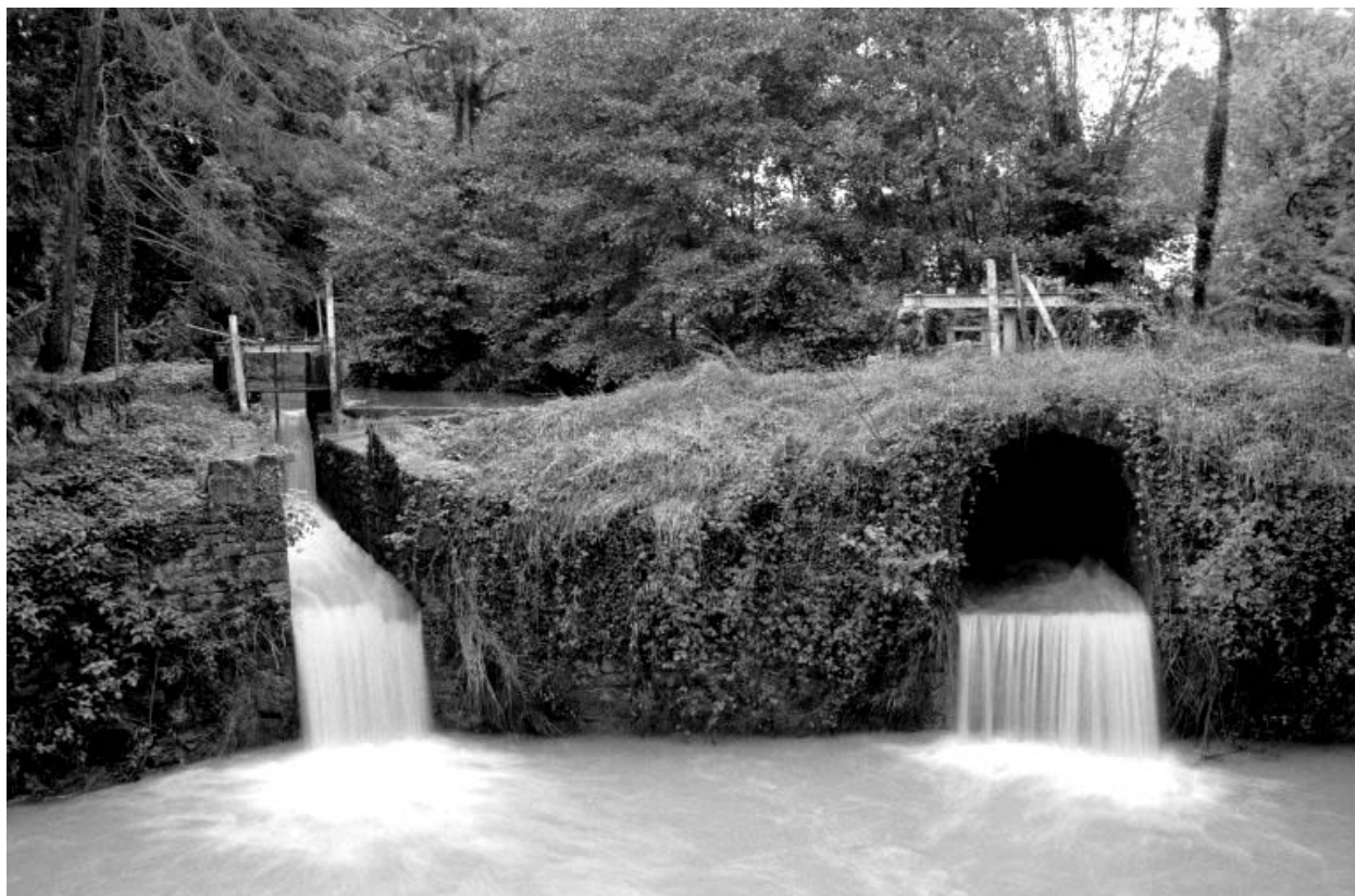
Vannes de décharge.
