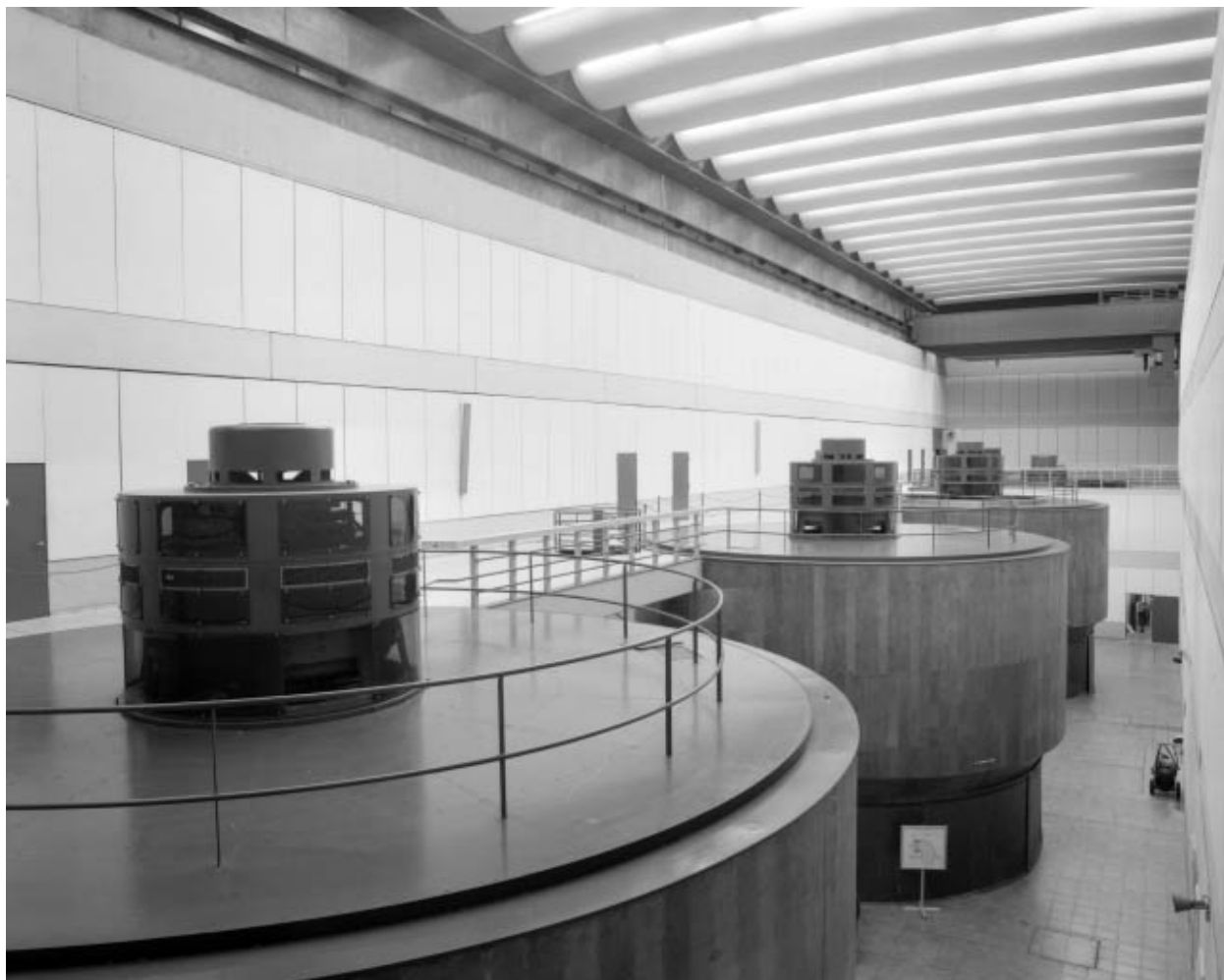
Barrage de Vouglans, Cernon : groupes n° 1 à 3.
