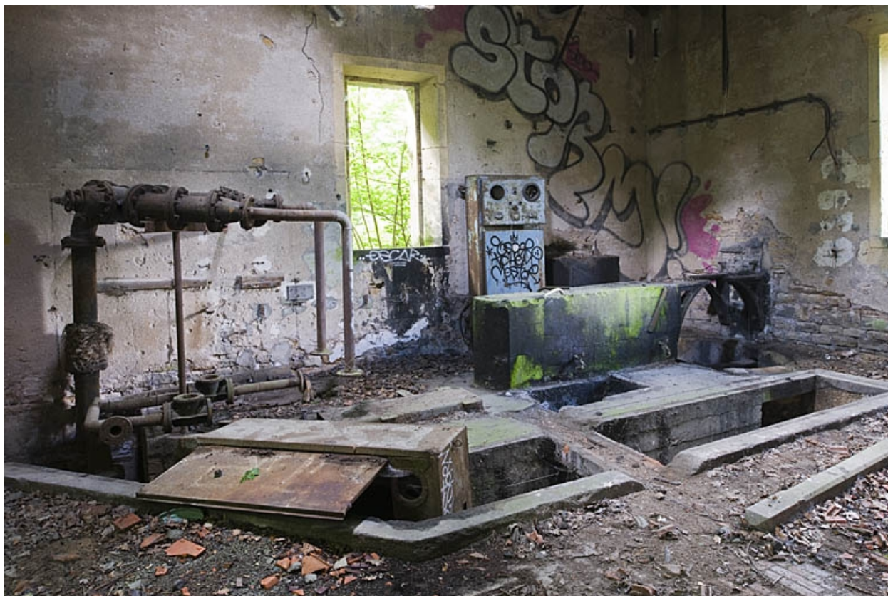
Station de pompage : Intérieur.
