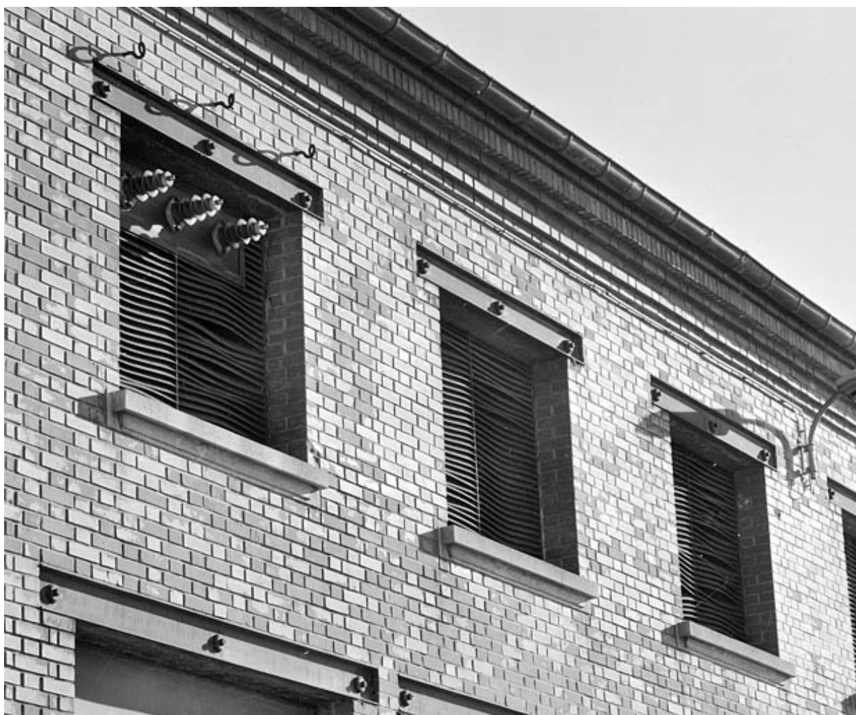
Transformateur : détail des baies supérieures.
