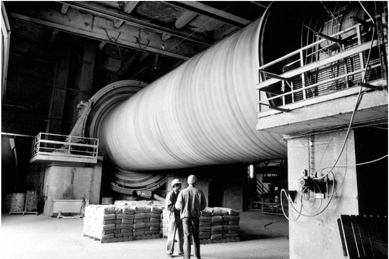
Atelier de fabrication : broyeur de clinkers.
